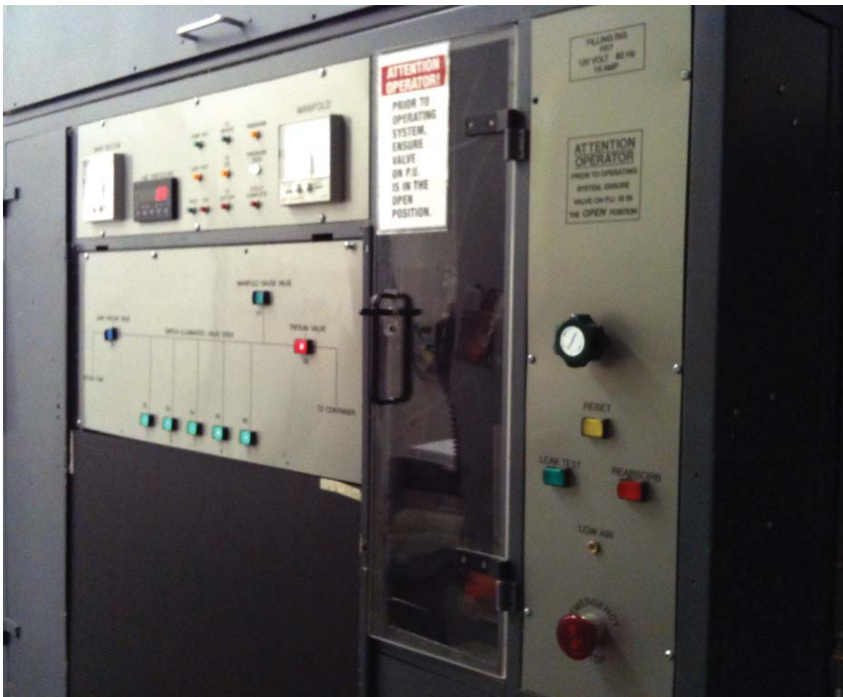
Un appareil de remplissage typique est utilisé pour remplir les tubes de verre avec du tritium gazeux dans une installation de sources lumineuses au tritium gazeux.
